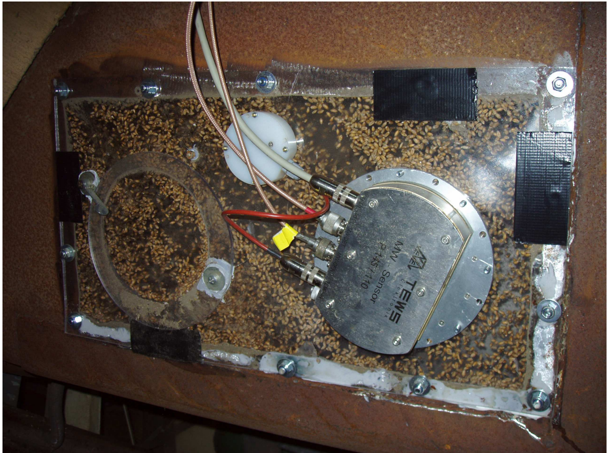
Abb. 6: Mikrowellenresonator mit Thermometer der Firma „TEWS Elektronik“ im Auslauftrichter eines im Betrieb befindlichen Durchlauftrockners
