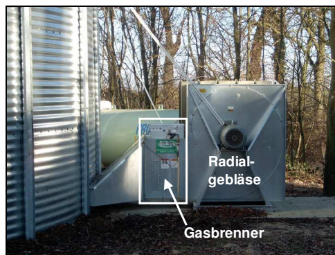
Abb. 17: Warmlufterzeuger aus Radialgebläse und direktem Gasbrenner, eingebaut zwischen Gebläse und Trocknungssilo.
