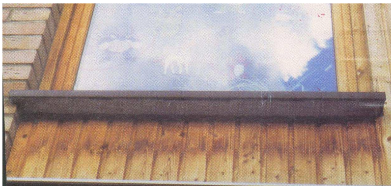
Abbildung 8: In direkter Witterung ausgesetzte Holzflächen haben nur eine geringe Haltbarkeit. Selbst unter der Fenster-Sohlbank ist ein gewisser Witterungsschutz gegeben.
