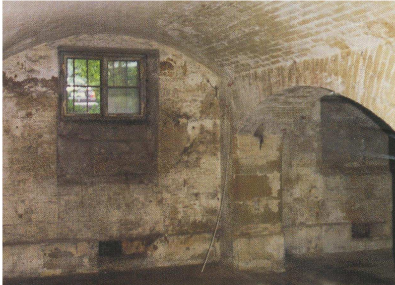
Abbildung 7: Hier trifft alles zusammen. Schlechte Lüftung, aufsteigende Feuchtigkeit und poröses Kellermauerwerk
