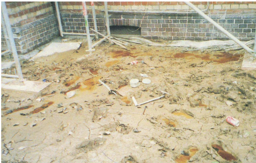
Abbildung 4: Das darf nicht sein! Fassadenabwässer und Chemikalien „Verschwindenden“ ungereinigt
