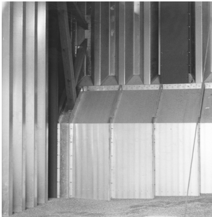
Abbildung 24: Stahlkanal - angebaut an eine Trapezprofil-Zellenwand mit eingebauten Hallen- und Zellenwandstützen - So nicht!
