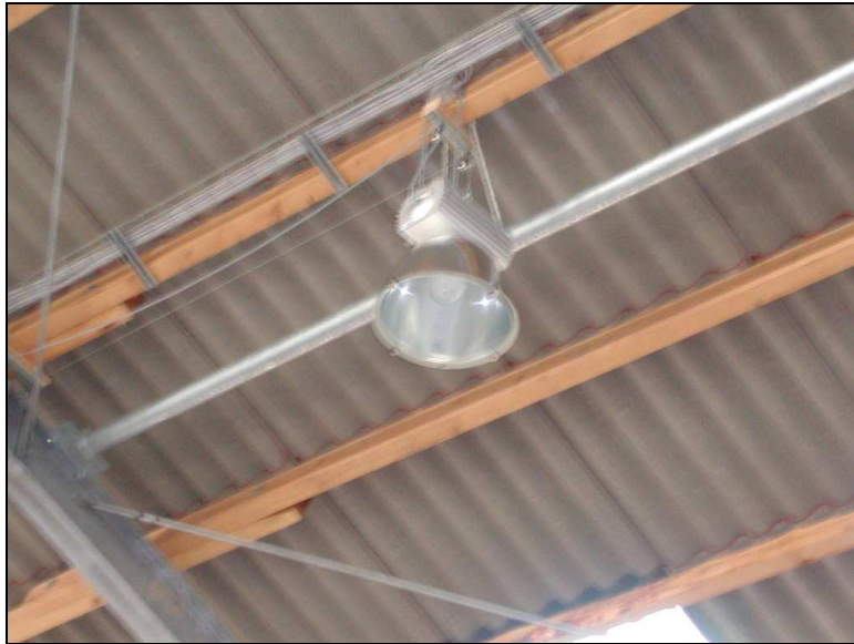
Abb. 4.8: Natriumdampf-Hochdrucklampen werden zur wirtschaftlichen Beleuchtung in Stallungen eingesetzt. Über eine Seilbefestigung mit Umlenkrolle kann die Lampe zur Reinigung oder zum Leuchtmittelwechsel abgesenkt werden.
